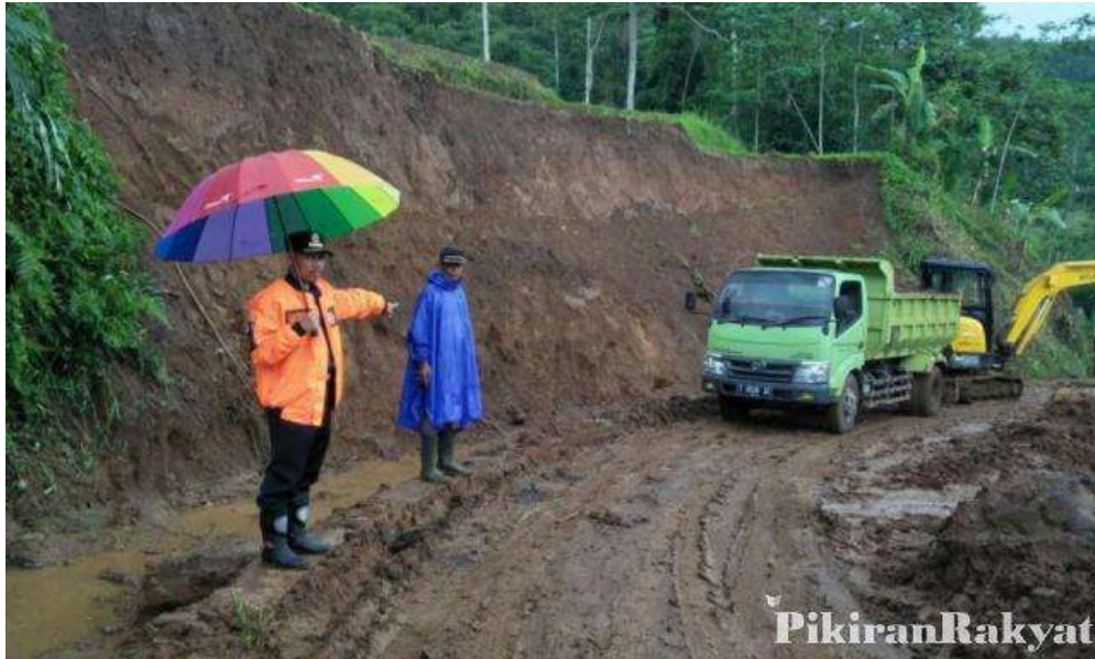
Gambar 1. Jalan tertimbun longsoran tanah
