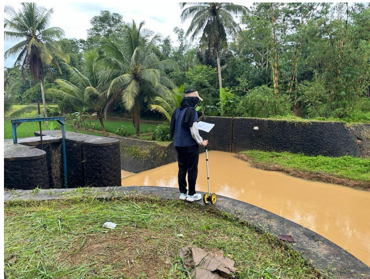
Gambar 1. 7 Inspeksi Kerusakan Pada Tubuh Bendung
