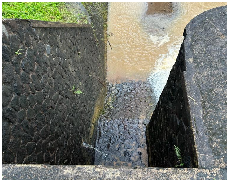
Gambar 1. 5 Rembesan Pada Bagian Tubuh Bendung
