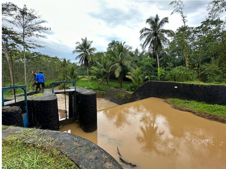
Gambar 1. 8 Bendung Daerah Irigasi Cimulek Kondisi Air Meluap
